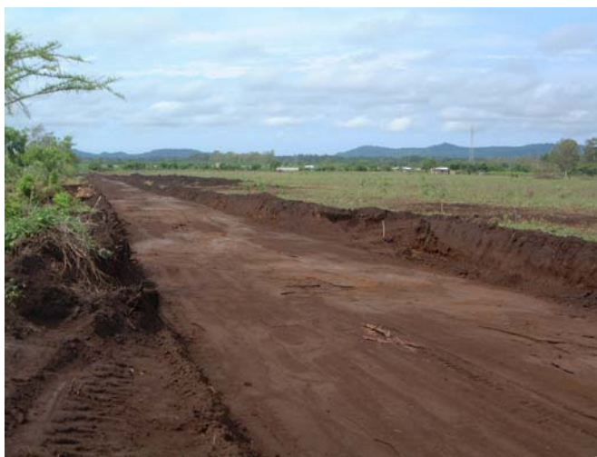
Calle sin pavimento
