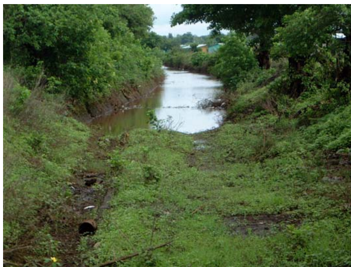
Zona de infiltración
