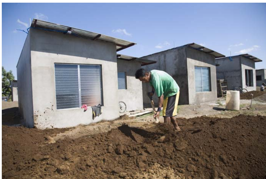
La mayoría de los habitantes construyen sus viviendas con sus propias manos
