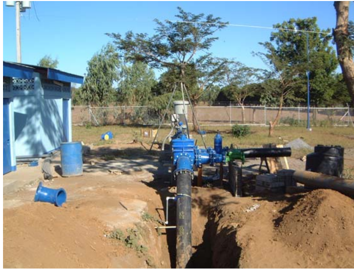
Sistema de agua potable instalado con fondos europeos
